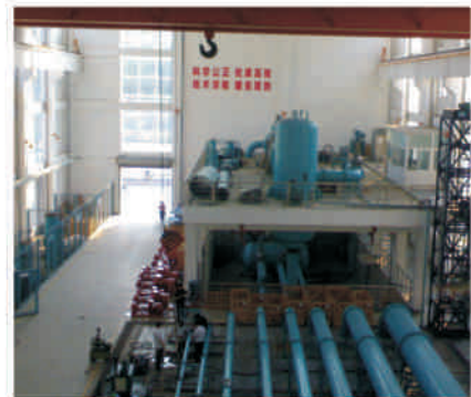
水泵测试中心
